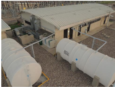
Figura 1. Sistema de recolección de aguas lluvias en ISA ENERGÍA COLOMBIA
